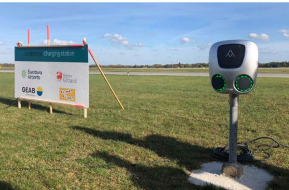
Laddstolpe för elflyg på Visby Airport.
